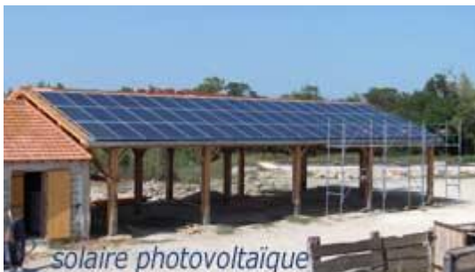
Les marais du Vigueirat. Panneaux solaires photovoltaïques.
