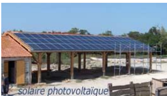
Les marais du Vigueirat. Panneaux solaires photovoltaïques.
